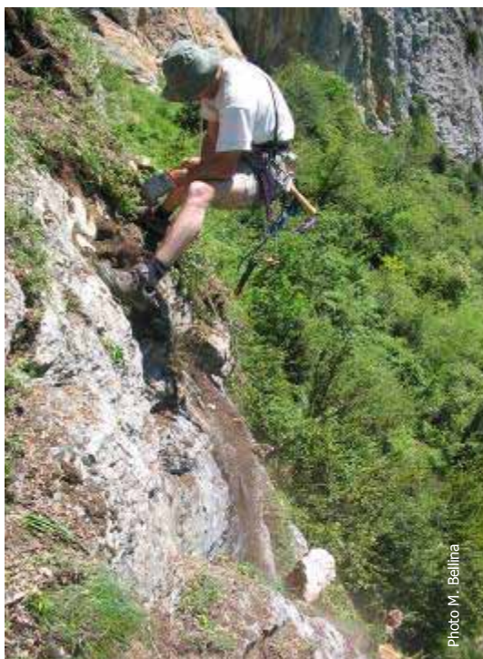
Purge à Génat
